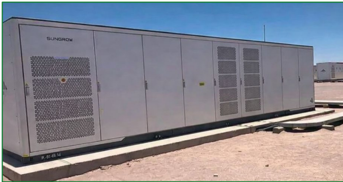
Local batterie BESS
