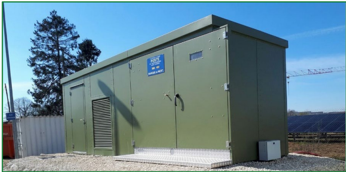
Poste de livraison combiné au poste de transformation
