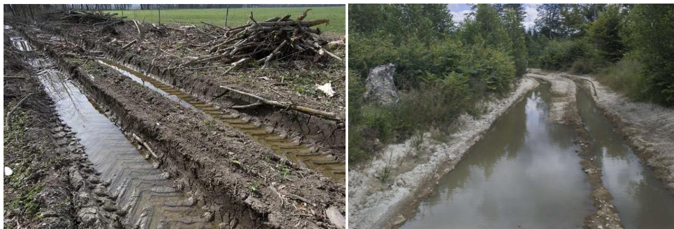
Figure 21 : Exemple d'ornières et dépressions à éviter
