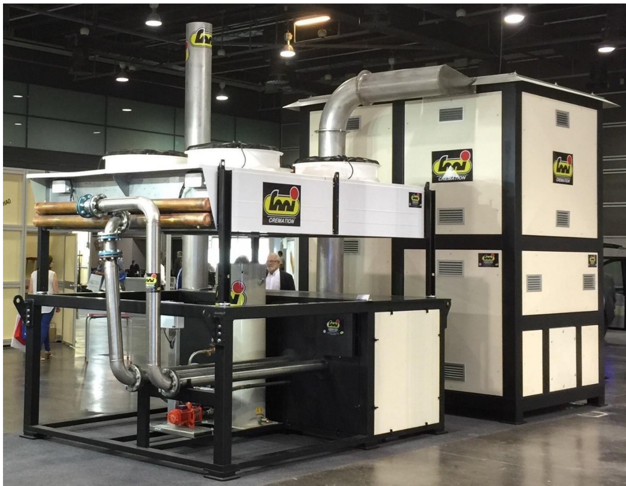
Système de filtration CLEANAIR PACK® - société FMI Process à L'Horme (42)
