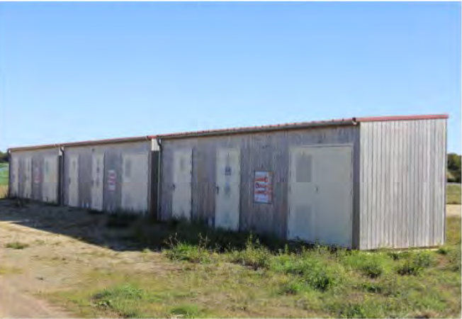
Photo 23 : Exemple d'un poste de livraison en bardage bois
