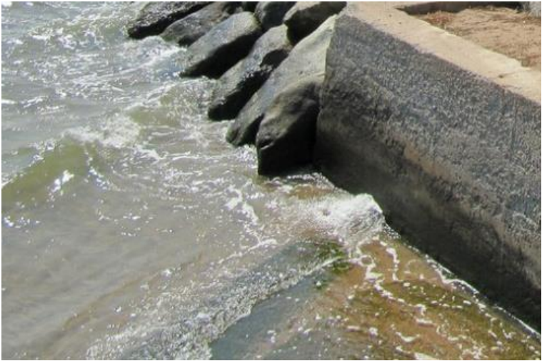
Algue verte sur la dalle béton
