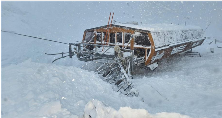
Figure 19 – Vue de la G12006 et du P12006 dont ne ressort que la tête sous le dépôt juste après l'avalanche du 17 février 2026
