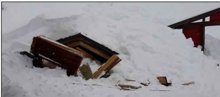
Figure 13 - Aperçu des dégâts de l'avalanche du 29 janvier 2021
