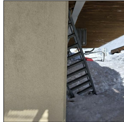
Figure 20 – Vue du déport de l'échelle d'accès à la machinerie et des dépôts sous la gare (photo prise 10 jours plus tard [1])
