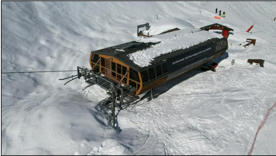
Figure 50 – Vue du dessus de la gare avec un trou dans la toiture
