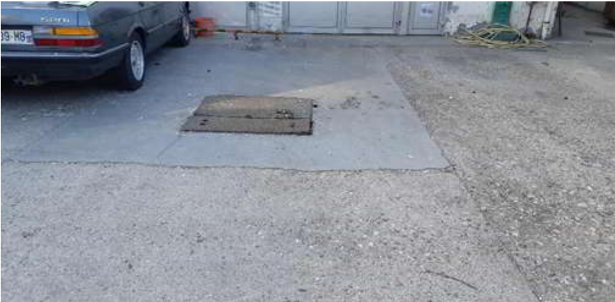
Vue sur la cuve aérienne dans le sous-sol (proche sondage T2)
