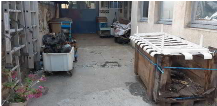
Zone de stockage de déchets / enrobé bitumineux fissuré, parcelle G182 (sondage T4)
