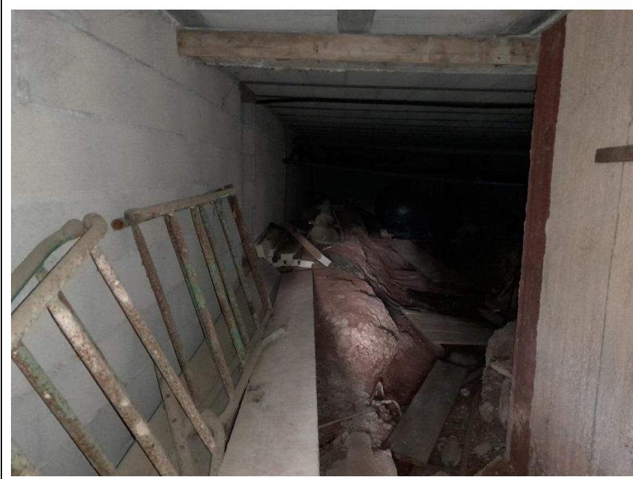
Parcelle 587 – Vide de construction et cuve de mazout en fond
