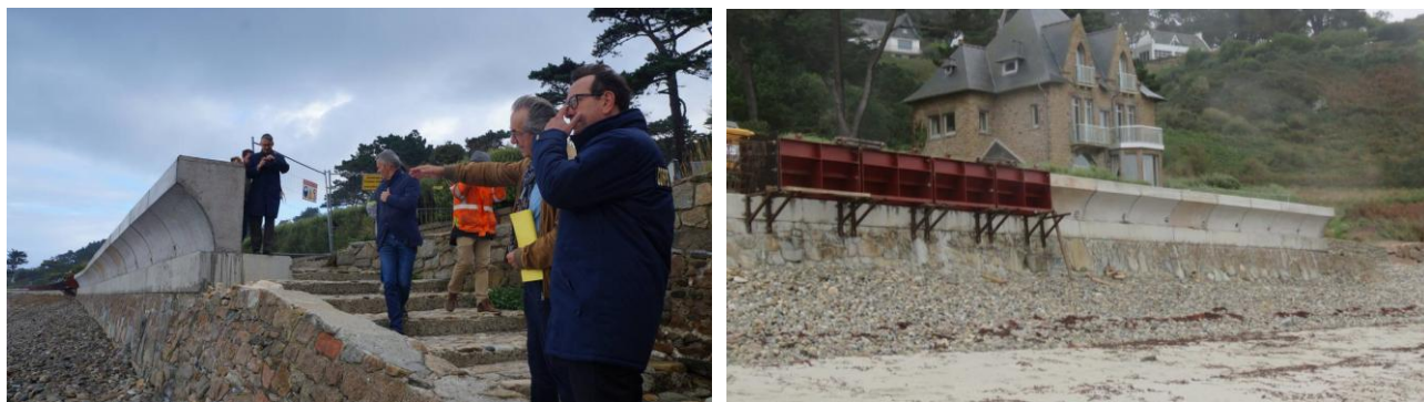
FIGURE 41. REHAUSSE DE LA DIGUE DE TREBEURDEN (SOURCES : OUEST-FRANCE A GAUCHE ET ACTU.FR A DROITE)
