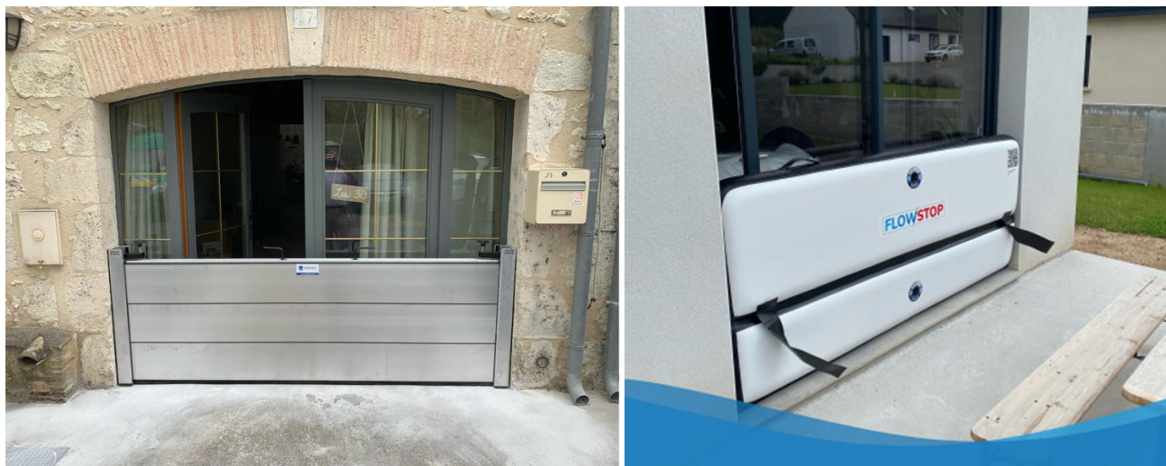
FIGURE 52. EXEMPLES DE BATARDEAUX POSITIONNES DEVANT DES BAIES VITRES
