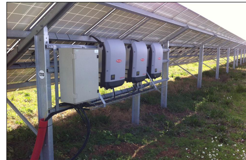
Photo 3 : Exemple d'onduleurs strings fixés à l'arrière des tables de modules
