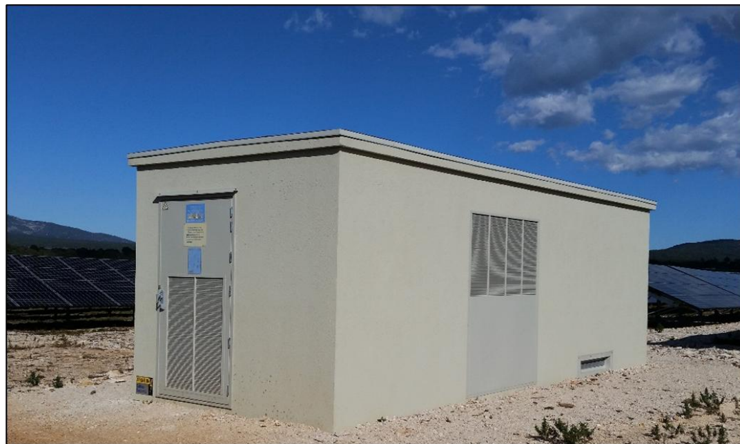
Photo 2 : Exemple de poste de transformation
