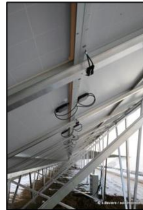
Photo 5 : Câblage sous les modules
