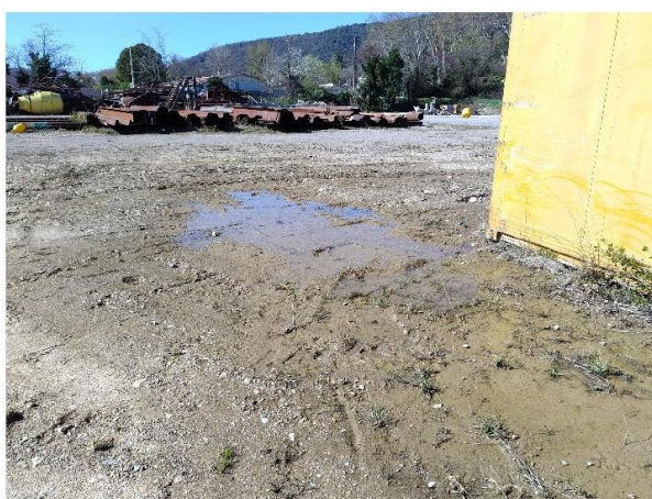
ORNIERES EN EAU LOCALISEES DANS LES ESPACES DE PLEINE TERRE
