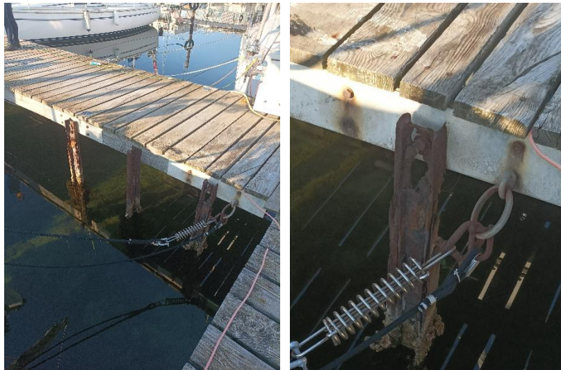
Figure 1-14 : Pieux métalliques corrodés (CREOCEAN, 2022)
