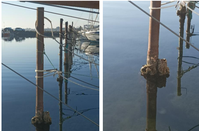
Figure 1-15 : Pieux d'amarrage corrodé, zone de marnage (CREOCEAN, 2022)
