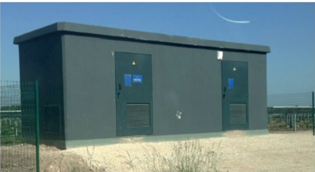
Poste de livraison
