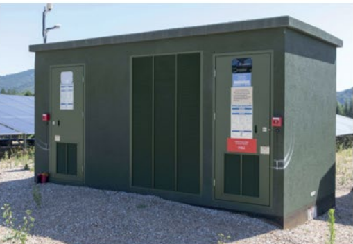
Poste de transformation
