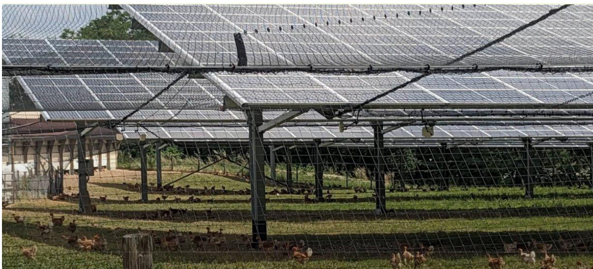
Figure 1 : Volière photovoltaïque dans le Lot-et-Garonne, réalisé par Mexens. Source : Mexens
