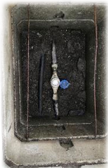
Compteur de distribution associé au réservoir de la Rochette (Cliché IATE du 03/04/2023)
