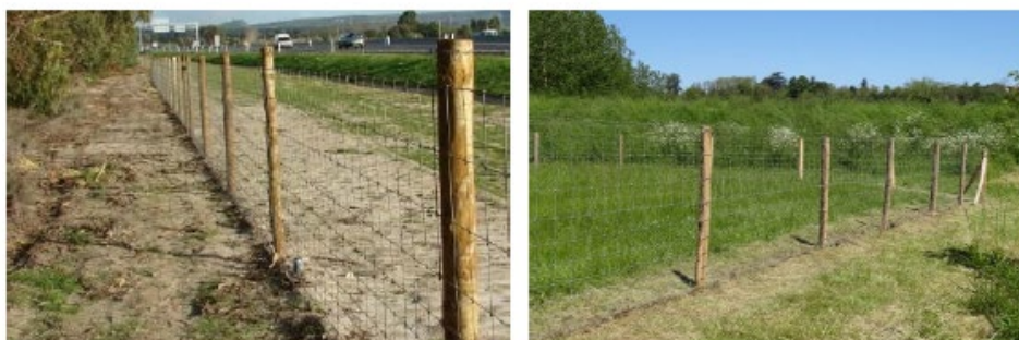
Figure 12 : Exemple d'une clôture de parc solaire
