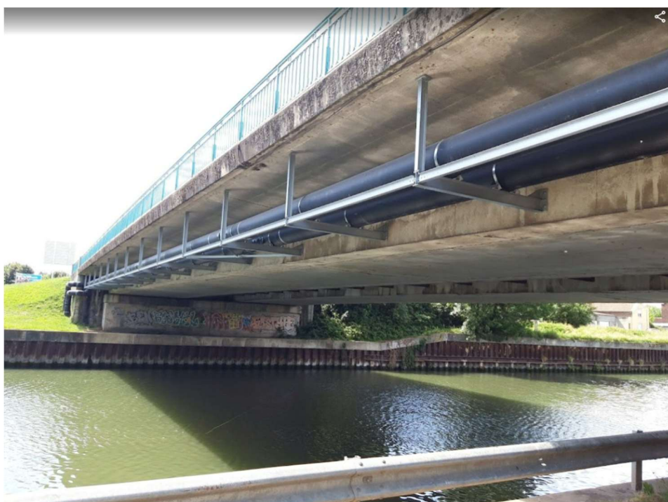
Figure 51 : Exemple de canalisation aérienne
