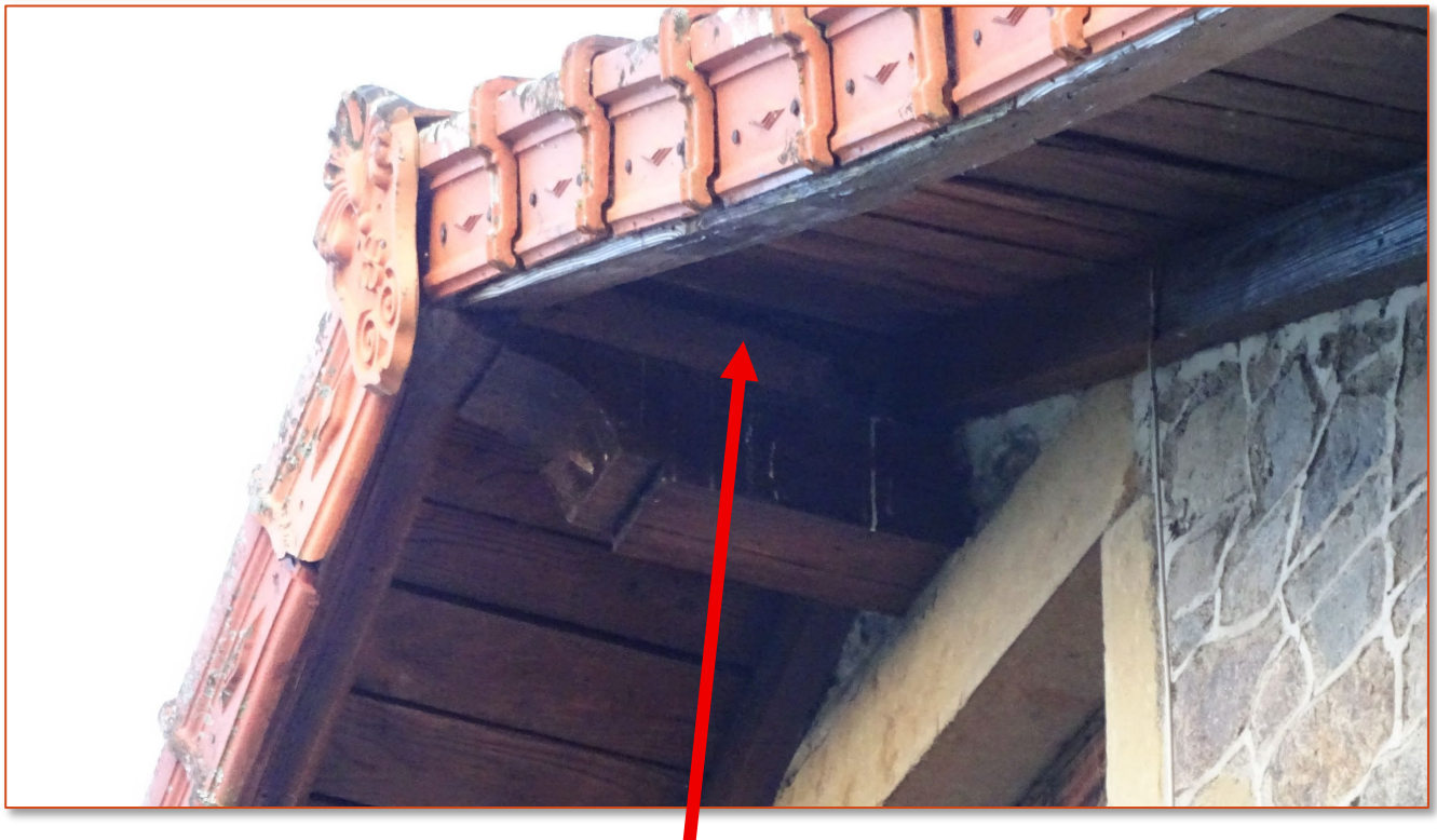
Figure 11. Vue zoomée sur le faitage de l'avancée de toit, gîte constaté.
