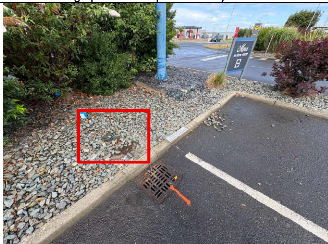
Photographie n°8 : séparateur d'hydrocarbures
