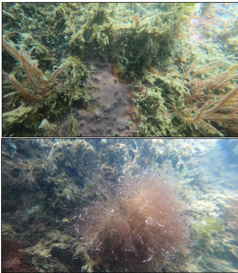
Figure 6 : Côté intérieur du mur submersible du port de Diélette recouverte d'algues rouges © TBM environnement 2026.
