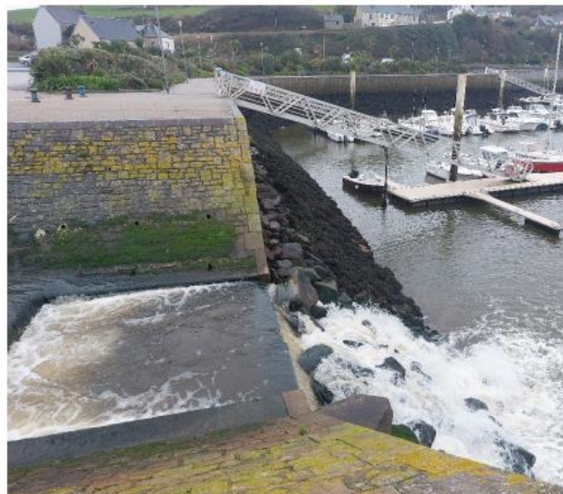
Figure 13 : Exutoire de la Diélette. Source : © TBM environnement 2026.
