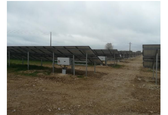
Onduleurs et câbles enfouis dans le sol
