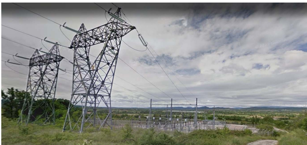
Figure 5 | Exemple de poste 225 000 volts
