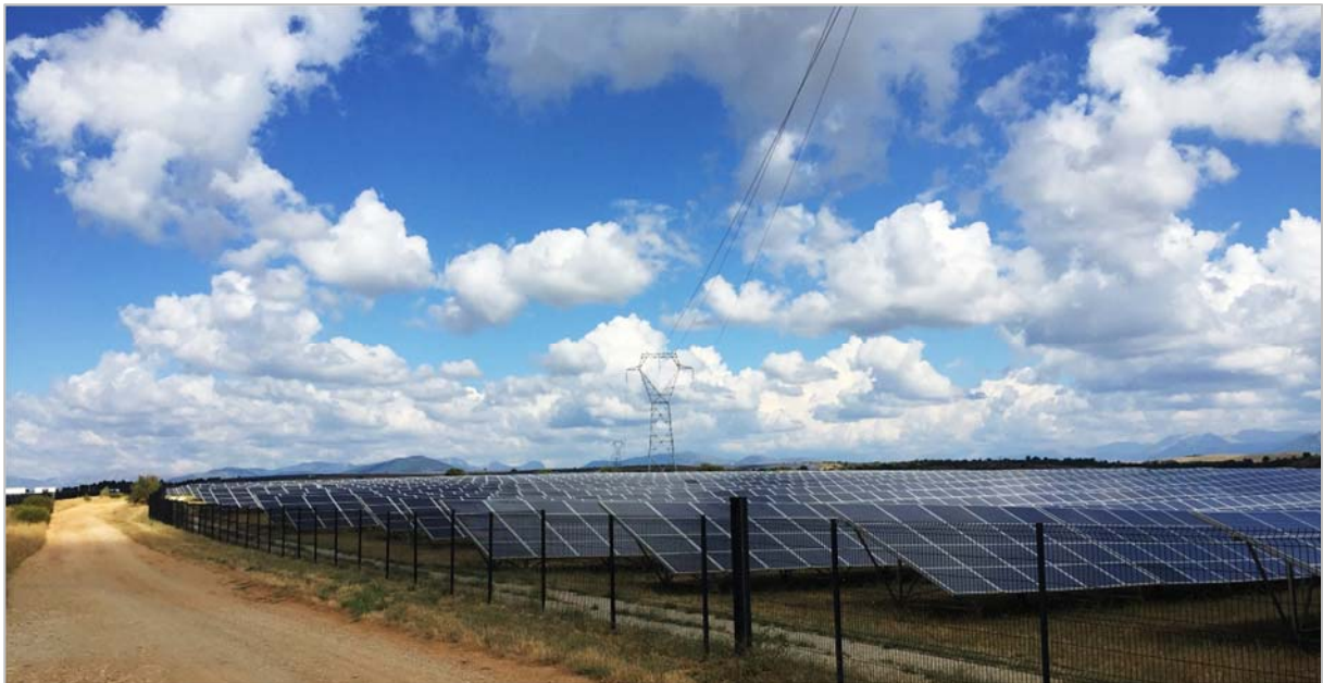
Figure 41 | Ligne aérienne 225 000 volts Oraison-Les Mées-St Auban surplombant un parc photovoltaïque longé par une piste
