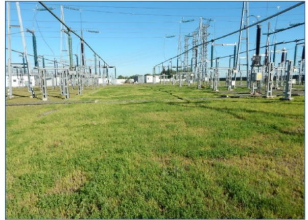
Figure 28 : Exemple de poste électrique végétalisé entretenu en zéro phyto
