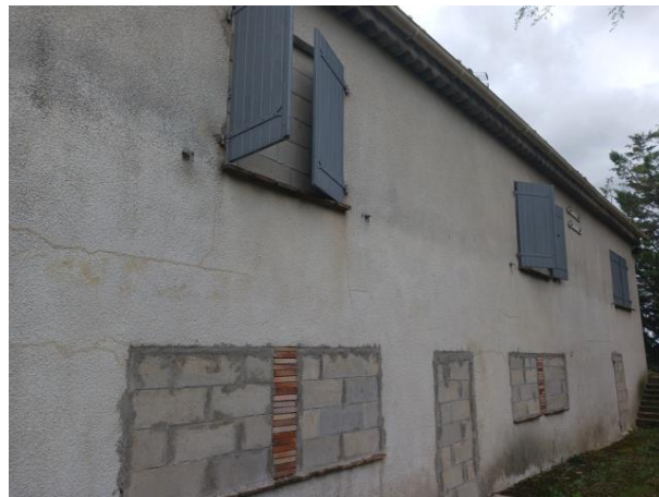
Figures 6 Portes et fenêtres sont complètement obstruées, les rendant hostiles à l'installation d'une colonie de chauves-souris
