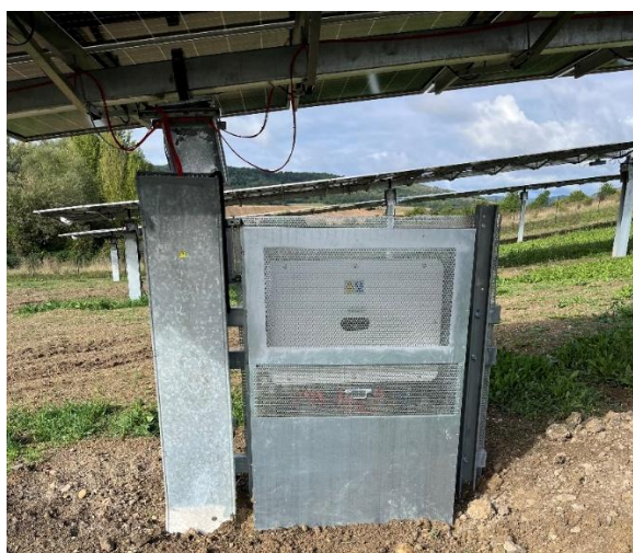
Figure 14 : onduleurs string (source TSE)
