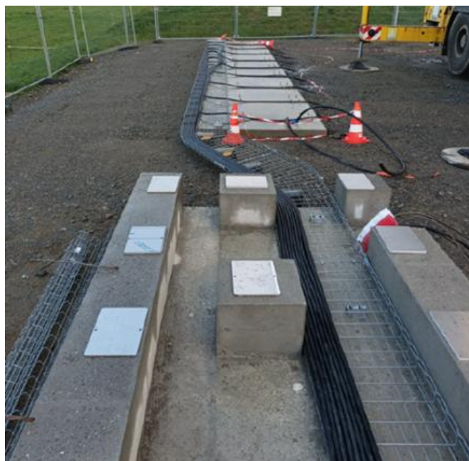
Figure 26 : Chemins de câbles pour le dispositif batterie (Source : TSE)
