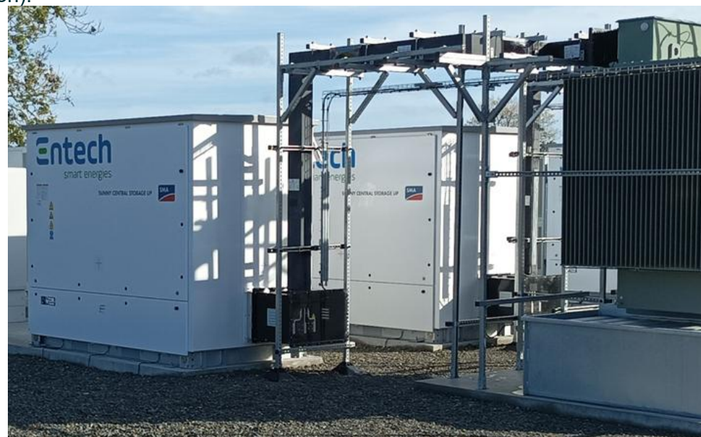
Figure 27 : « jeu de barres » entre PCS et un transformateur de puissance BT/HTA (Source : TSE)
