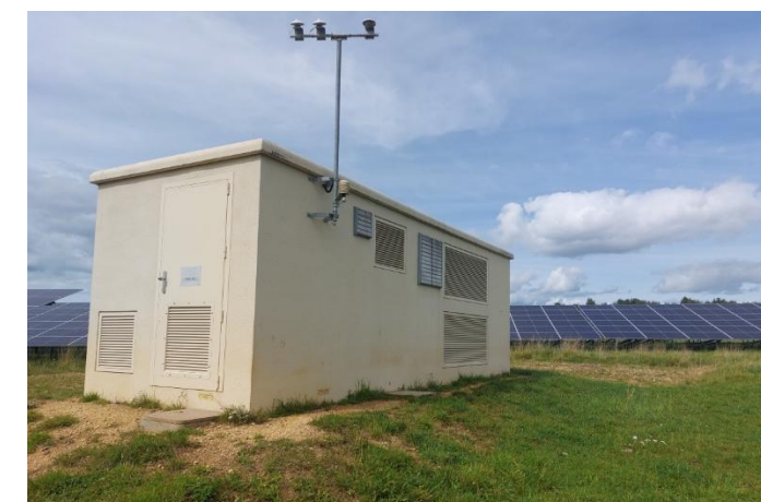
Figure 16 : Exemple de local technique (source TSE)
