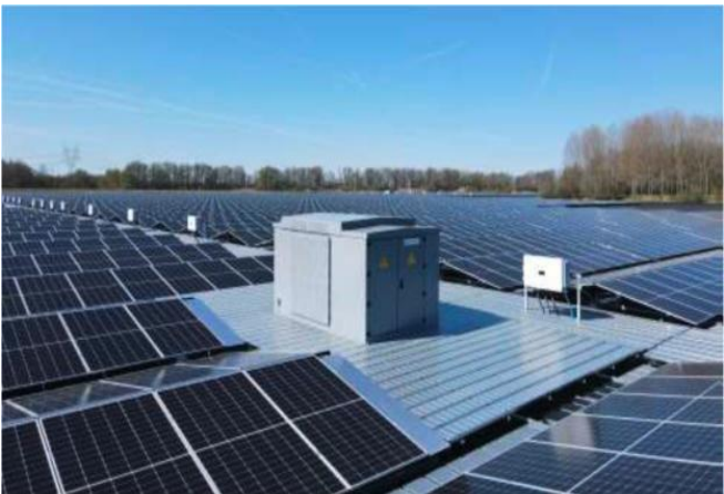
Figure 2 : Exemple de centrale photovoltaïque flottante
