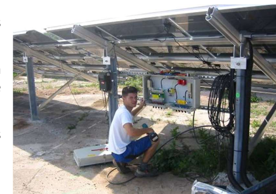
Raccordement de câbles solaires en coffret électrique
