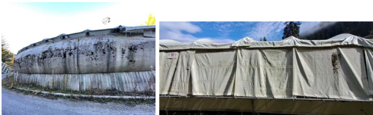
Figure 15 : Calorifugeage et bâchage dégradés de la piste actuelle
