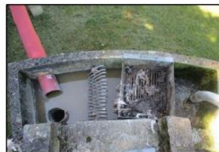
By pass et Dégrieur
