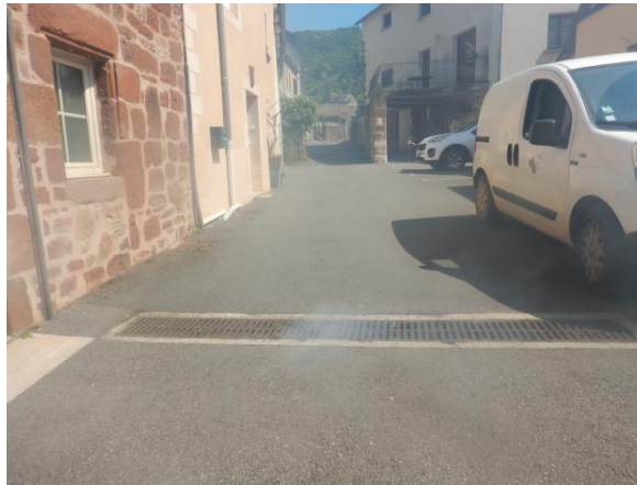
Chemin de grille EP Rue du Chateau
