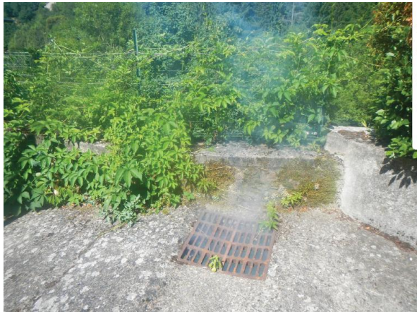
Grille EP Rue du Côté
