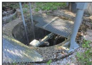
Absence de barreaux anti-chute
