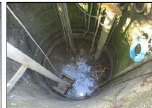
Poste de relèvement
