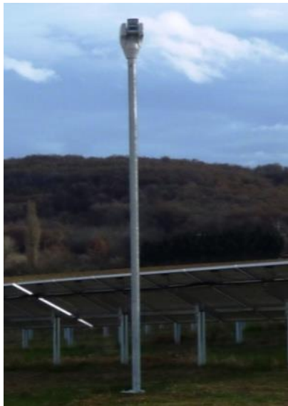
Mât de surveillance
