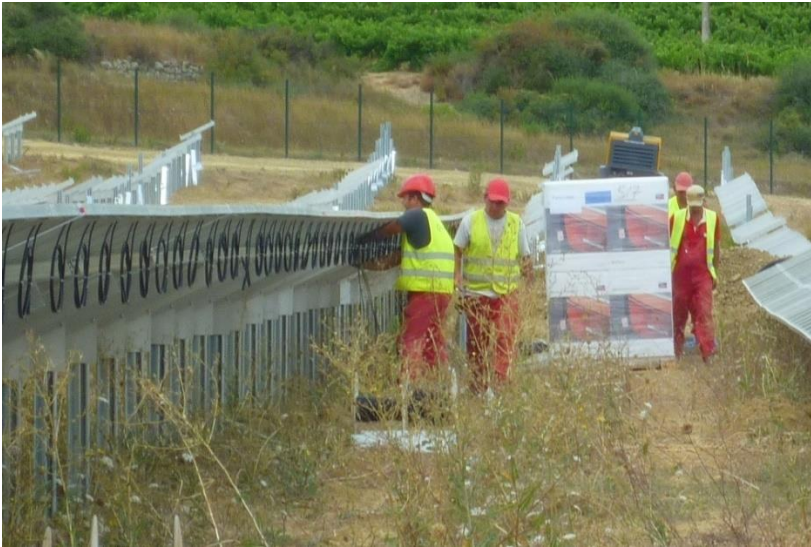
Câblage et interconnexion des modules photovoltaïques
