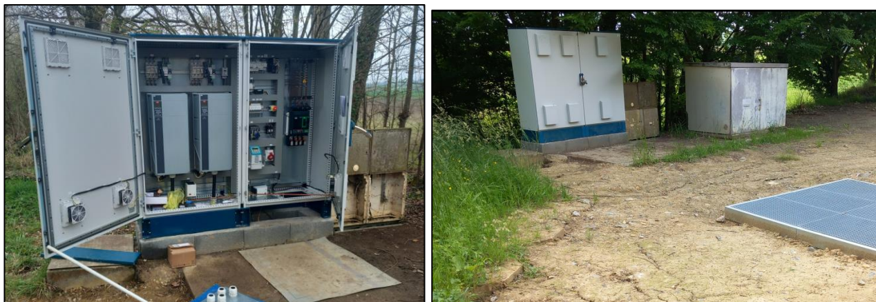
Figure 13 : Exemple d'armoire électrique sur pompe d'exhaure en berge de cours d'eau, RIVES&EAUX.
