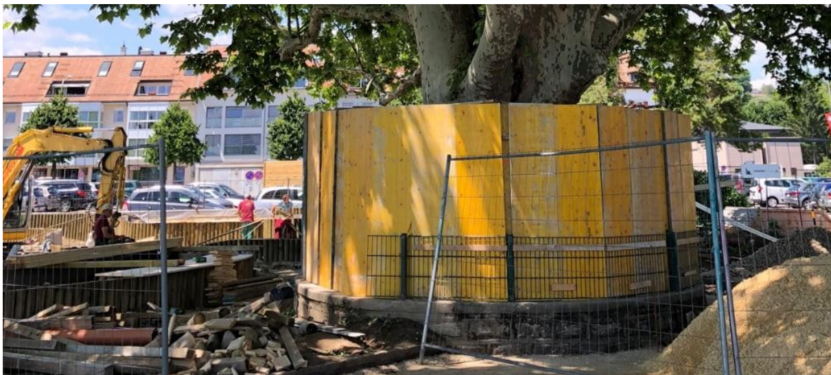
Exemple de protection
