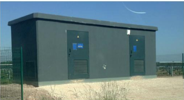
Poste de livraison
