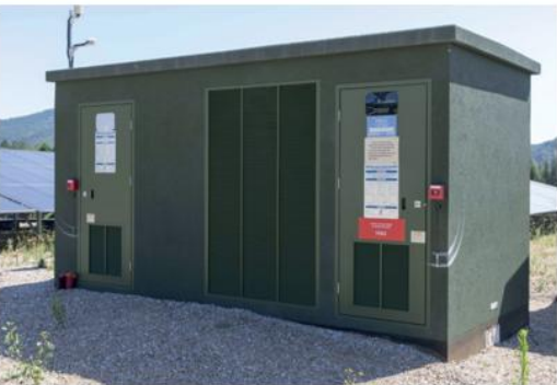
Poste de transformation
