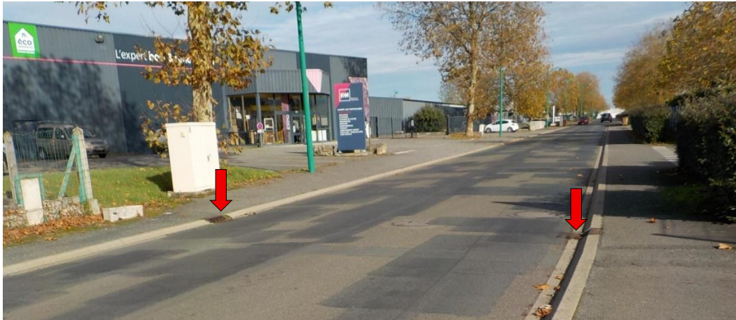
Rue Denis Papin équipée d'avaloirs EP
