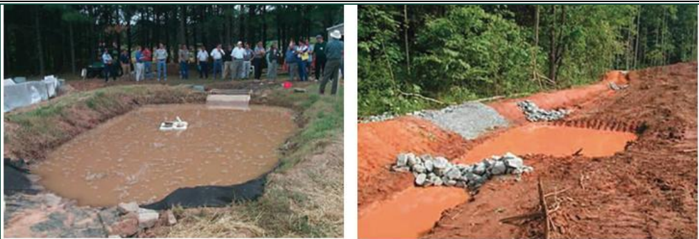
Piège à sédiments avec berges végétalisées.
