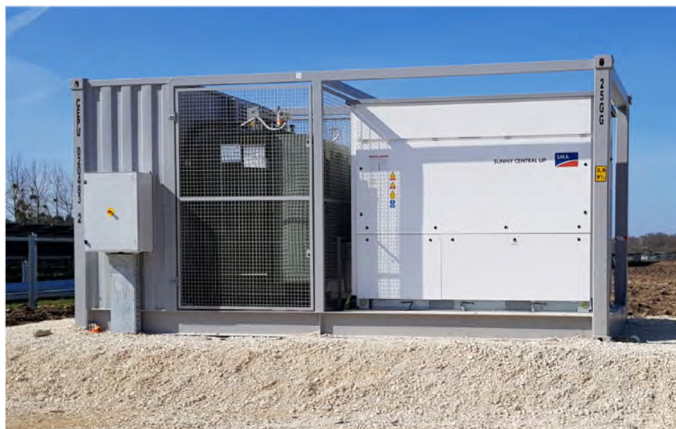
Figure 53 : Poste de transformation
