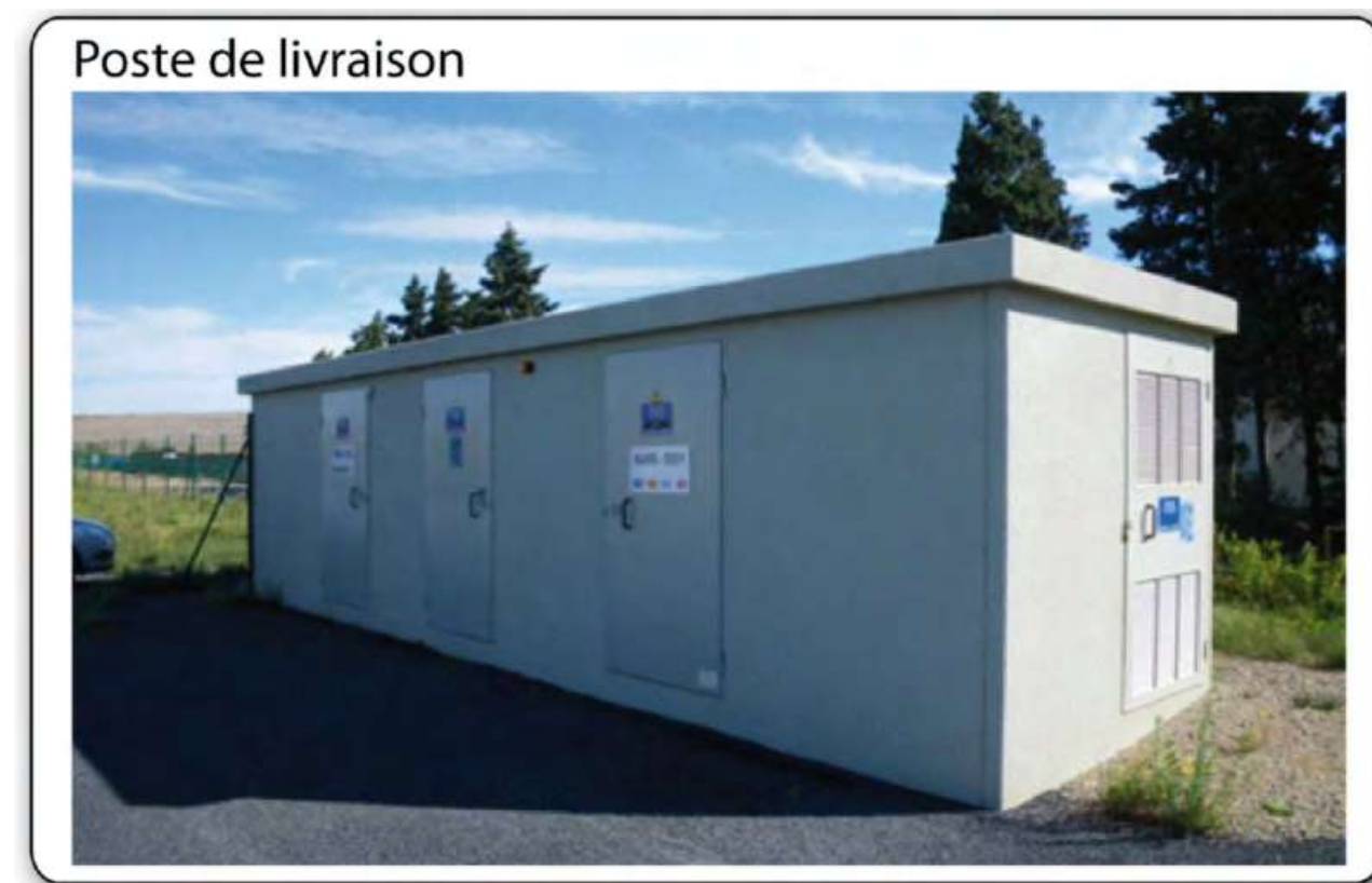
Figure 54 : Poste de livraison
