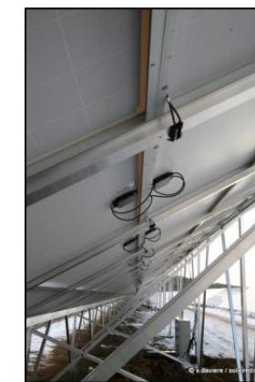
Photo 5 – Câblage sous les modules
