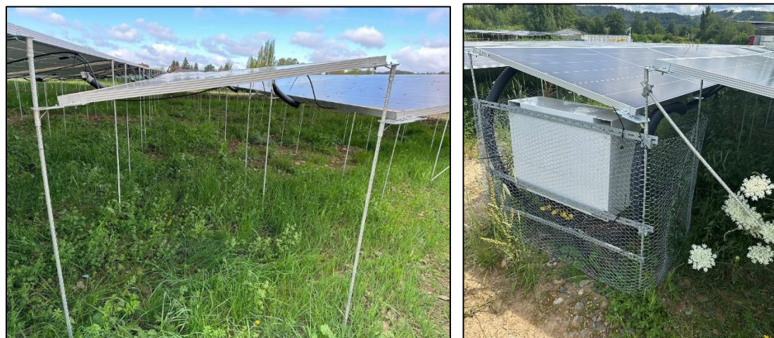
Photo 9 : A gauche : Câblage des panneaux – A droite : Boitier de raccordement – Source : BEC Energy Consult
