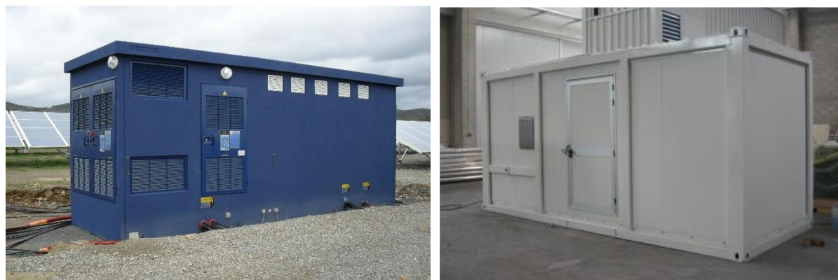
Photo 3 : Exemple d'onduleurs et de poste de transformation installés dans des postes béton et containers
