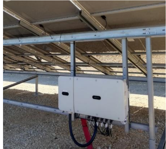
Onduleurs décentralisés (string)
