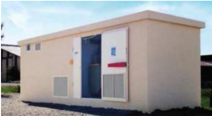
Poste de livraison et de transformation
