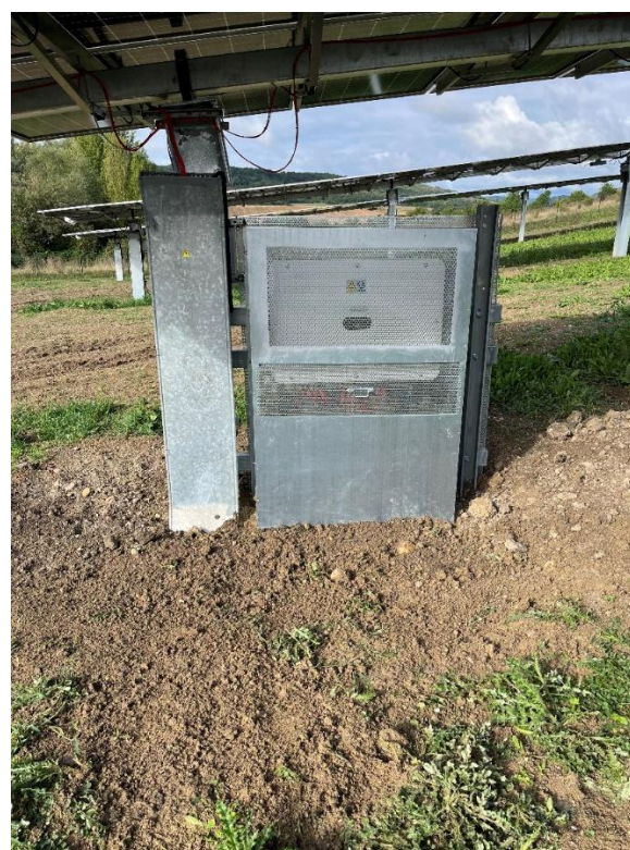
Figure 17: onduleurs string (source TSE)
