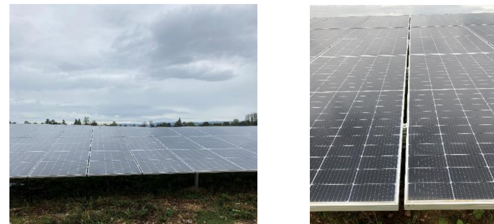
Figure 21 : Exemple d'interstices de panneaux disjoints
