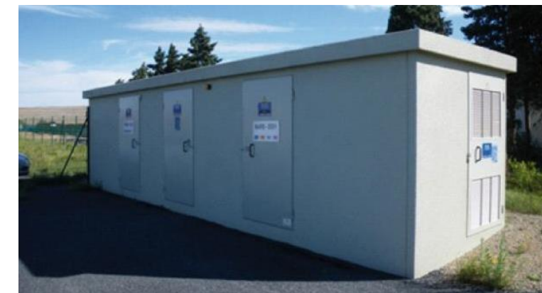
Photographie 5 : Poste de livraison (Source : ENCIS Environnement)
