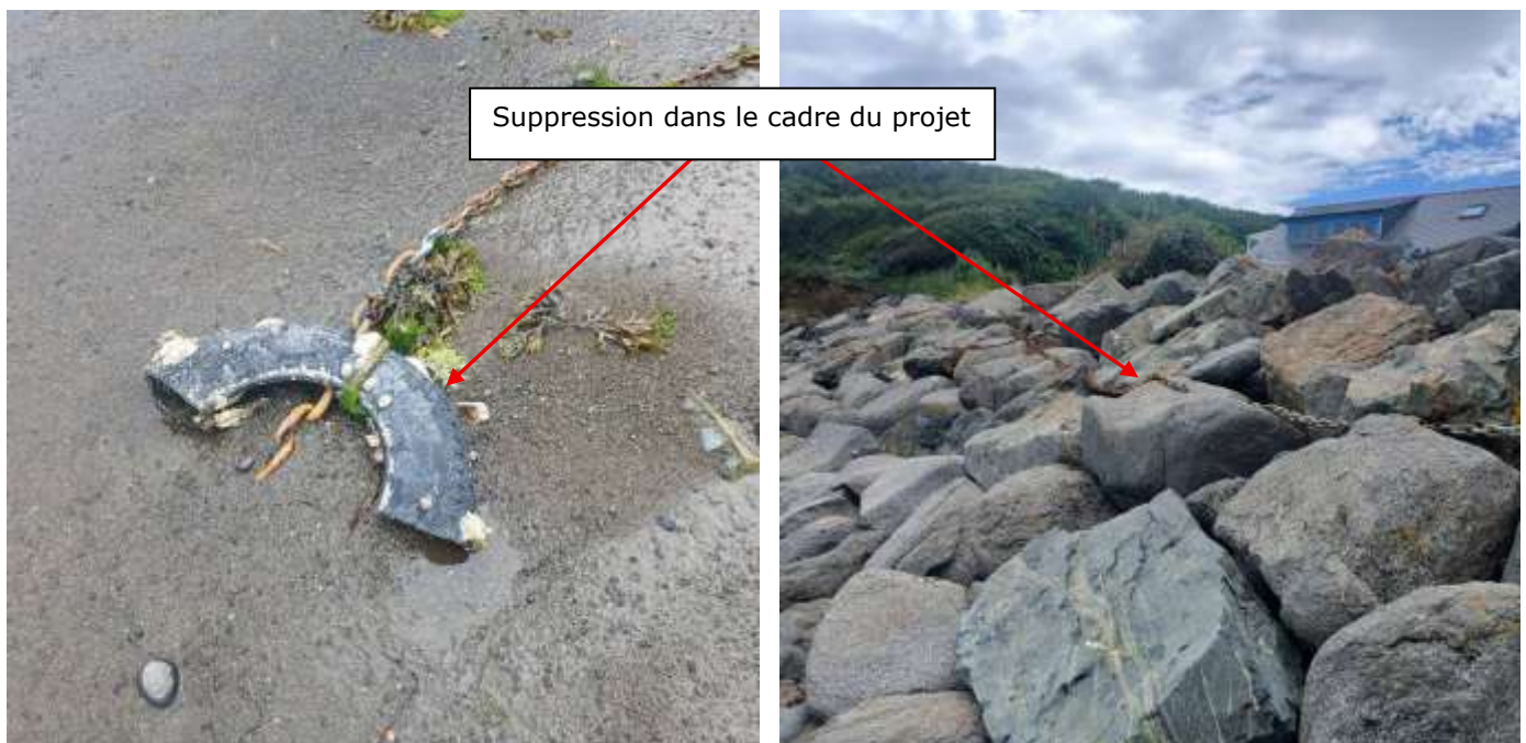
Figure 35 : Vues de bout de pneu sur l'estran (à gauche) et de chaîne acier dans les enrochements (à droite) qui seront supprimés dans le cadre du projet.
