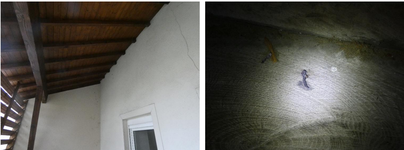
Figure 16 : Charpente du dernier pallier à gauche et excrément de rat retrouvé dans la cage d’escalier à droite © EODD, 2026
