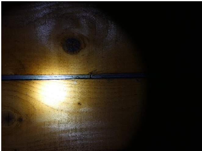
Figure 49 : Espace très resserrée entre les liteaux avec les ardoises déposées juste au-dessus © EODD, 2026
