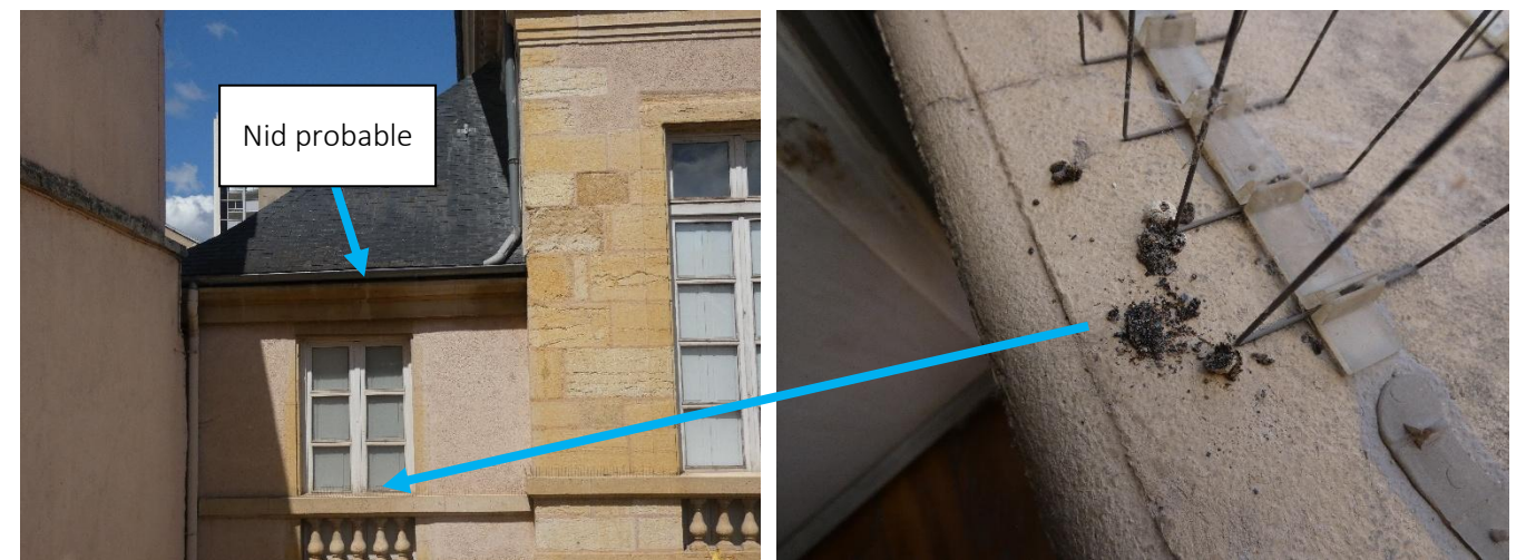
Figure 47 : Portion du bâtiment où de l'activité de martinets a été observée à gauche et excréments retrouvés sur le rebord de la fenêtre à droite © EODD, 2026
