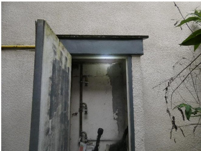
Figure 21 : Compteur d'énergie © EODD, 2026
