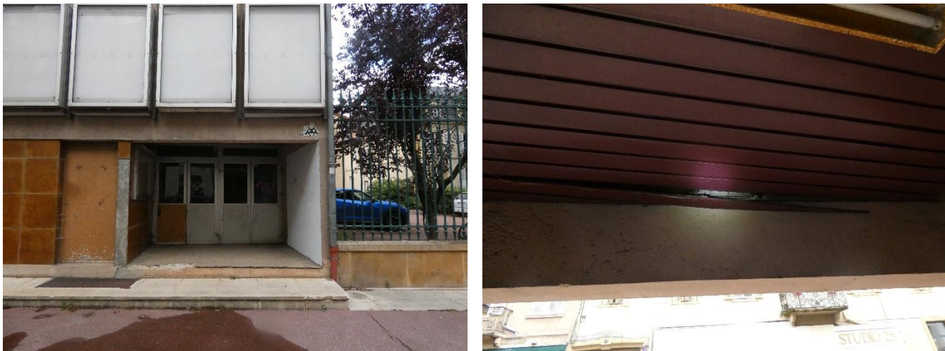
Figure 39 : Entrée avec du lambris en partie abîmé © EODD, 2026
