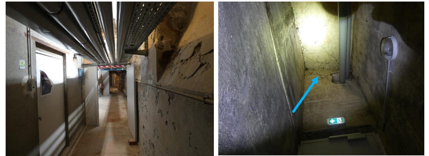
Figure 46 : Un des couloirs du sous-sol à gauche et plafond d'une des pièces avec des nombreuses toiles d'araignées © EODD, 2026
