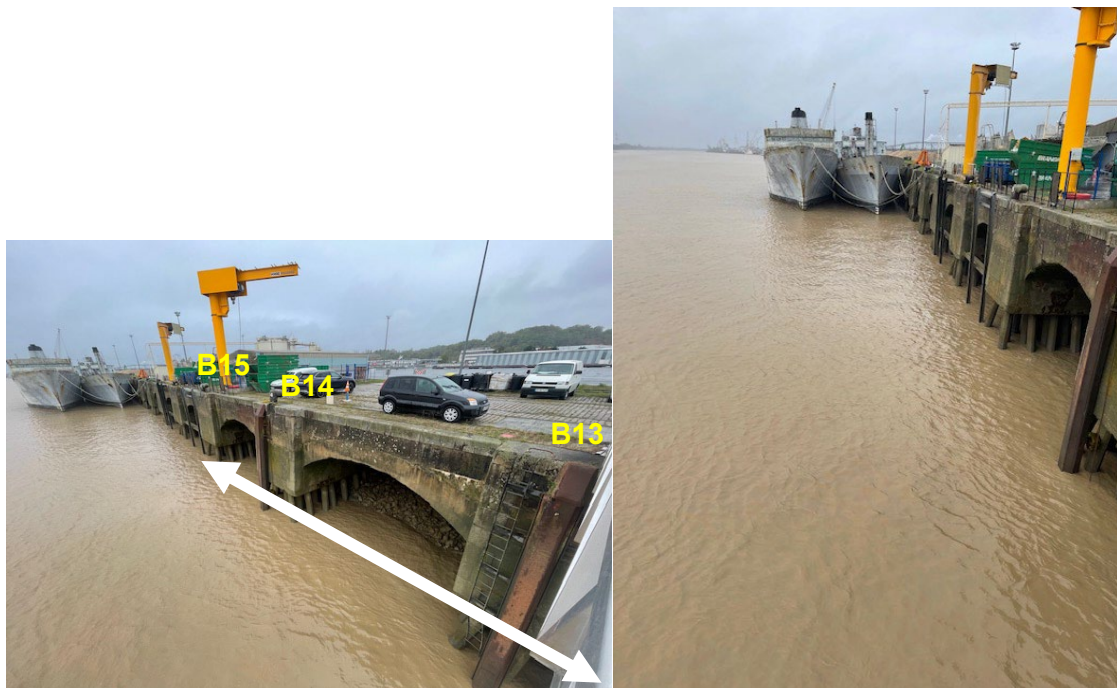
Marée basse : octobre 2023
