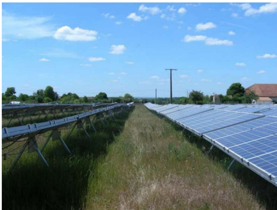
Photo 1 : centrale de Courbillac (16) groupe UNITE
