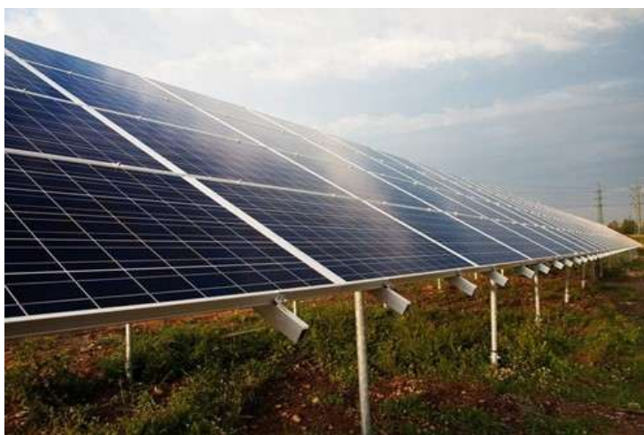
Figure 13 : Panneaux photovoltaïques (Source : omeo.com)
