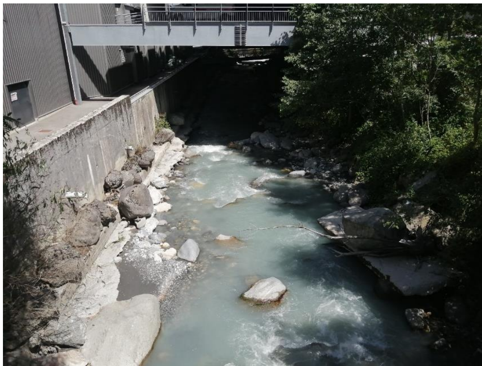
Figure 21 : Doron de Belleville amont couverture Super U : déchaussement des fondations – LOMBARDI 2021
